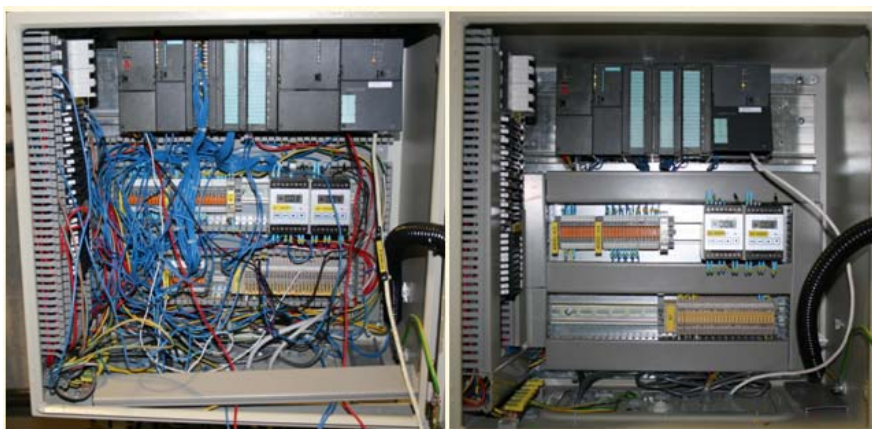
Figur 3-4 Til venstre skap 4000 før gjennomgang, til høyre etter.
