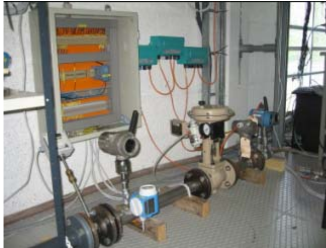
Figur 3-7 Lufttilførsel med instrumenter i forgrunnen. Koblingsbokser for feltbuss og krysskoblingskap i bakgrunnen.
