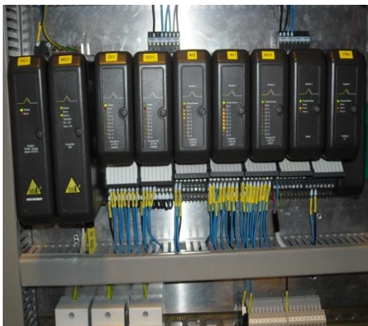
Figur 2-3 Skap 4100 i kontrollrommet som inneholder maskinvare til DeltaV.
